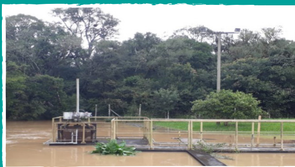
Estação de Tratamento de Água do Miringuava após fortes chuvas (01/06/2019)
